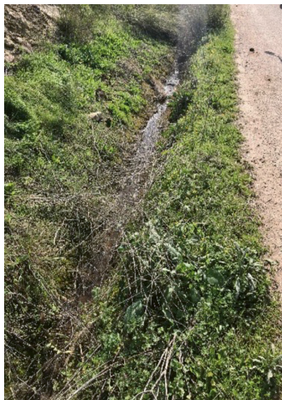
Figura 7.3.4.6. Aspecto del talud lateral de la tercera balsa; se aprecia la escorrentía del residuo líquido producido por rebose y filtraciones de la tercera balsa
